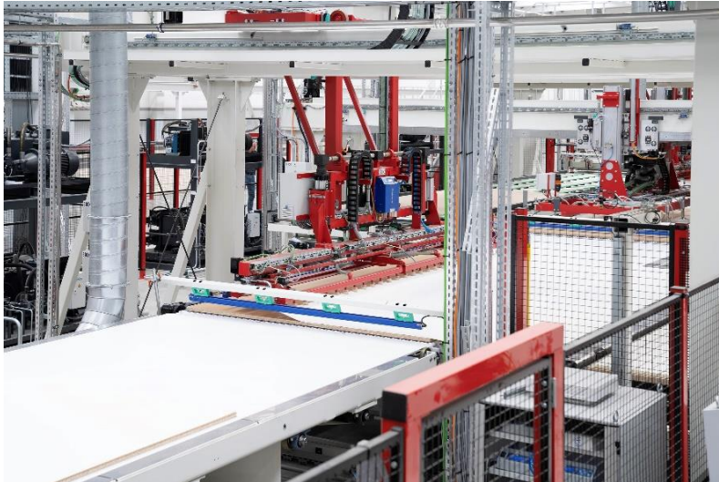
Bild 2: Die neue Kurztaktpresse dient zur Herstellung der Durat Oberflächen für Türen und Zargen. Nahezu vollautomatisch werden die mit Melaminharz beschichteten Dekor-papiere auf MDF- und Spanplatten mit einer Gesamtpresskraft von ca. 6.600 Tonnen gepresst.
